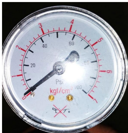
Figura 9.15 — Tentativa de quantificação do biogás pelo manômetro instalado no botijão
