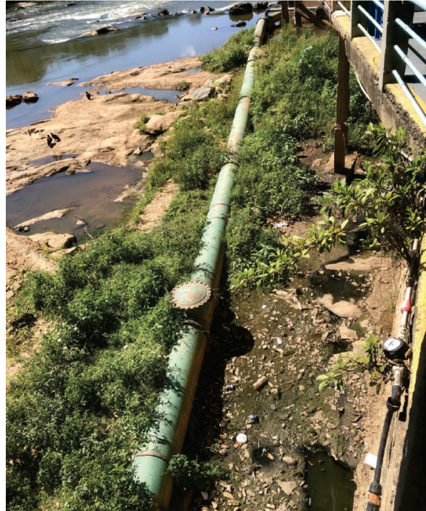
Figura 42 – Cano interceptor de esgotos residenciais no Centro de Cachoeiro de Itapemirim
