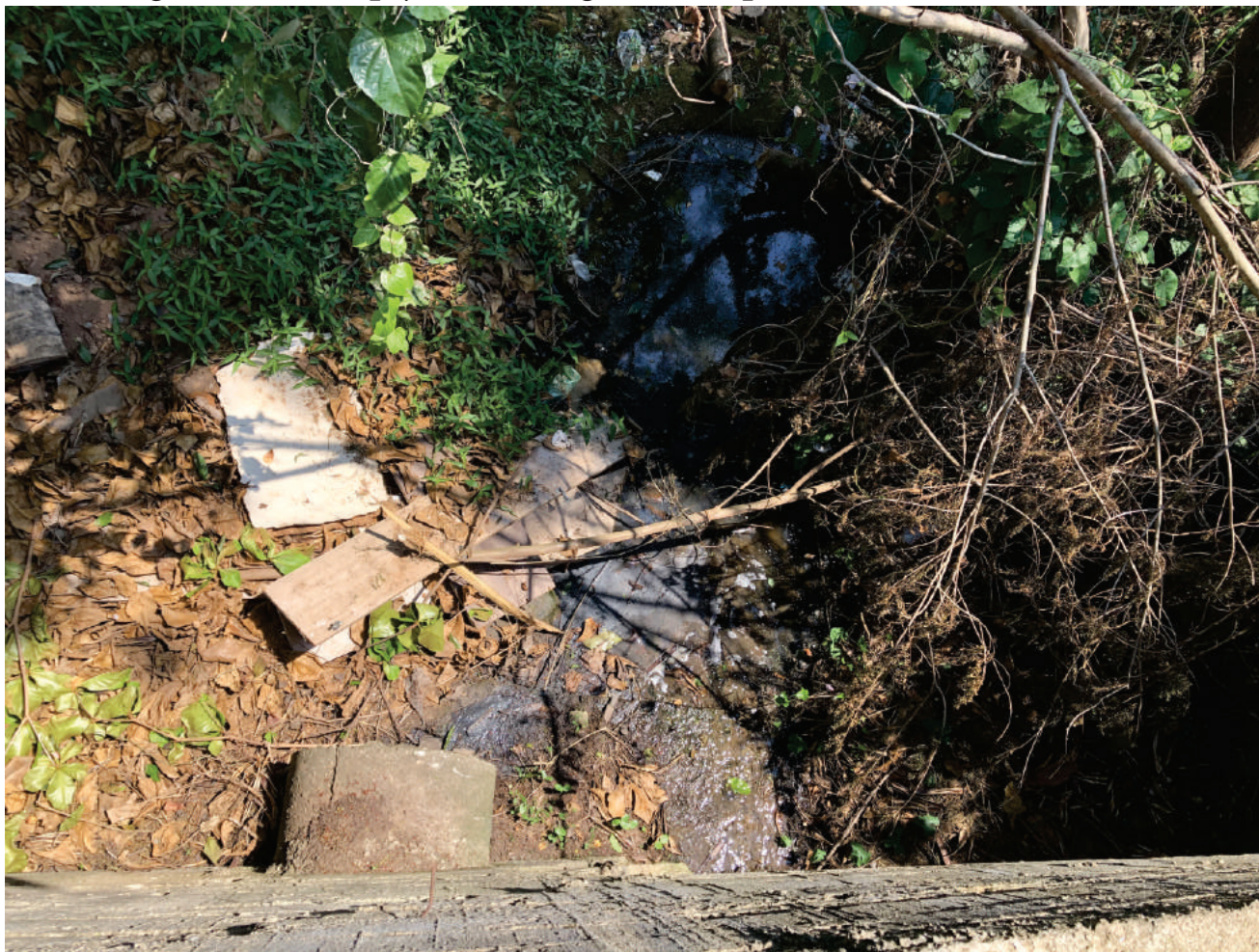
Figura 49 – Esgoto sendo despejado às margens do Itapemirim na Avenida Carlos Lindenberg
