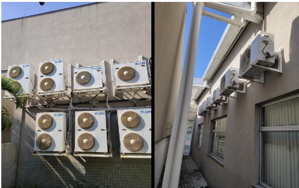
Figura 6 – Fachadas externas com as unidades condensadoras instaladas.
