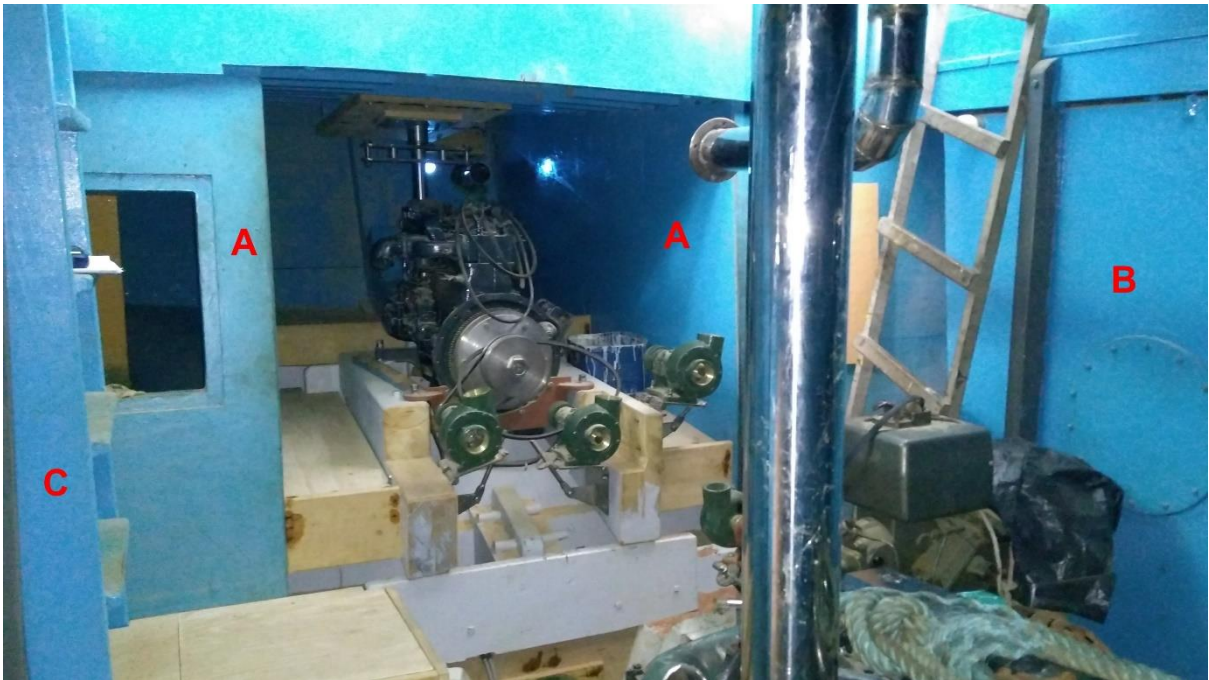
Figura 13 - Interior da praça de máquinas.
