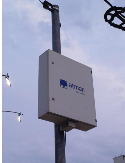
Figura 4 – Controlador de tráfego
