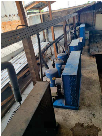
Figura 10 – Compressores de refrigeração
