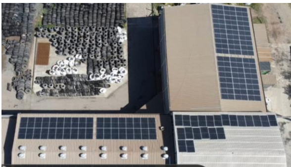
Fig. 2: Localização do sistema fotovoltaico [Acervo do Autor].
