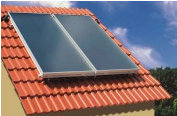
Figura 2 – Painel solar térmico
