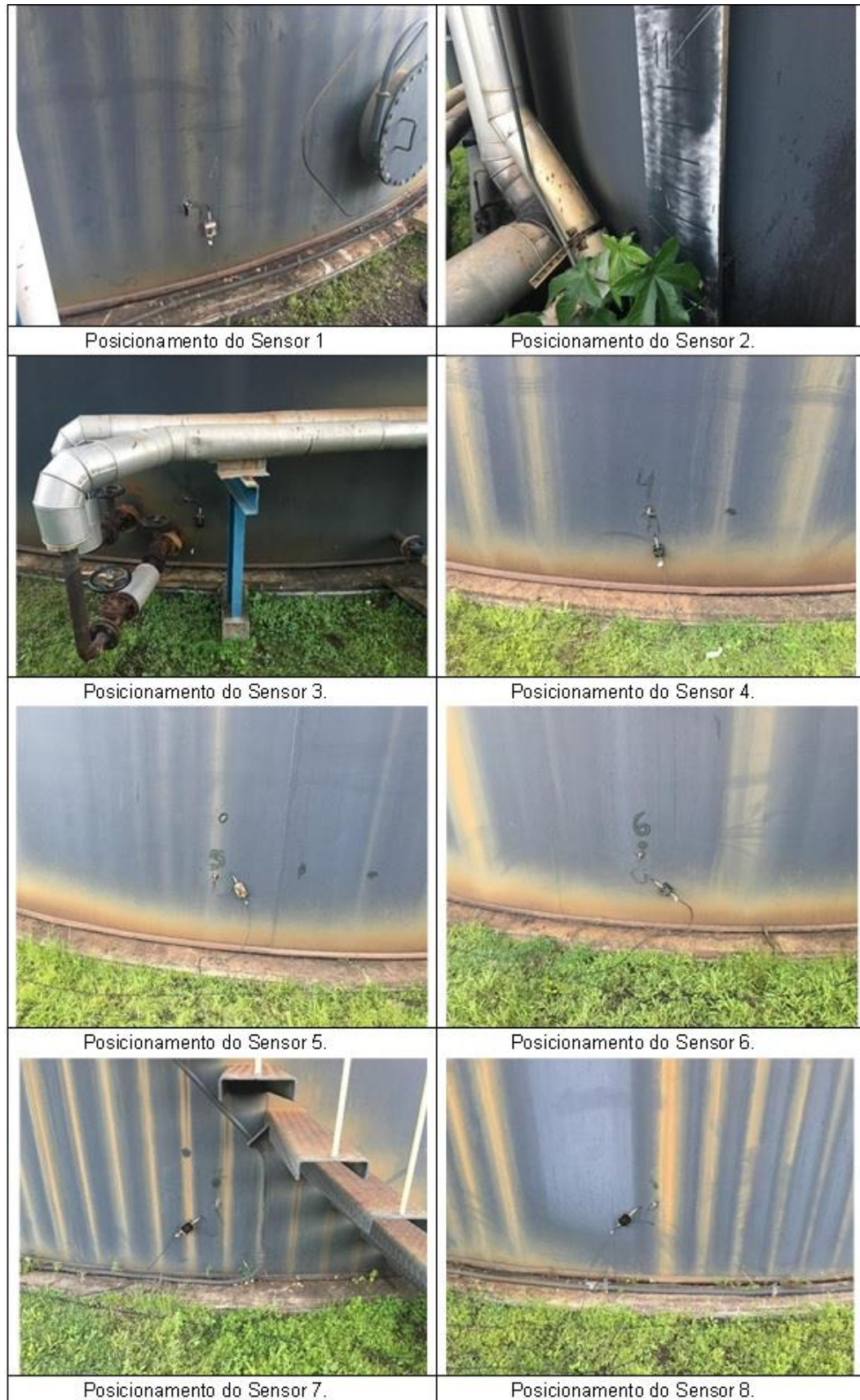
Figura 11 – Posicionamento dos sensores instalados no TQ-01-HFO
