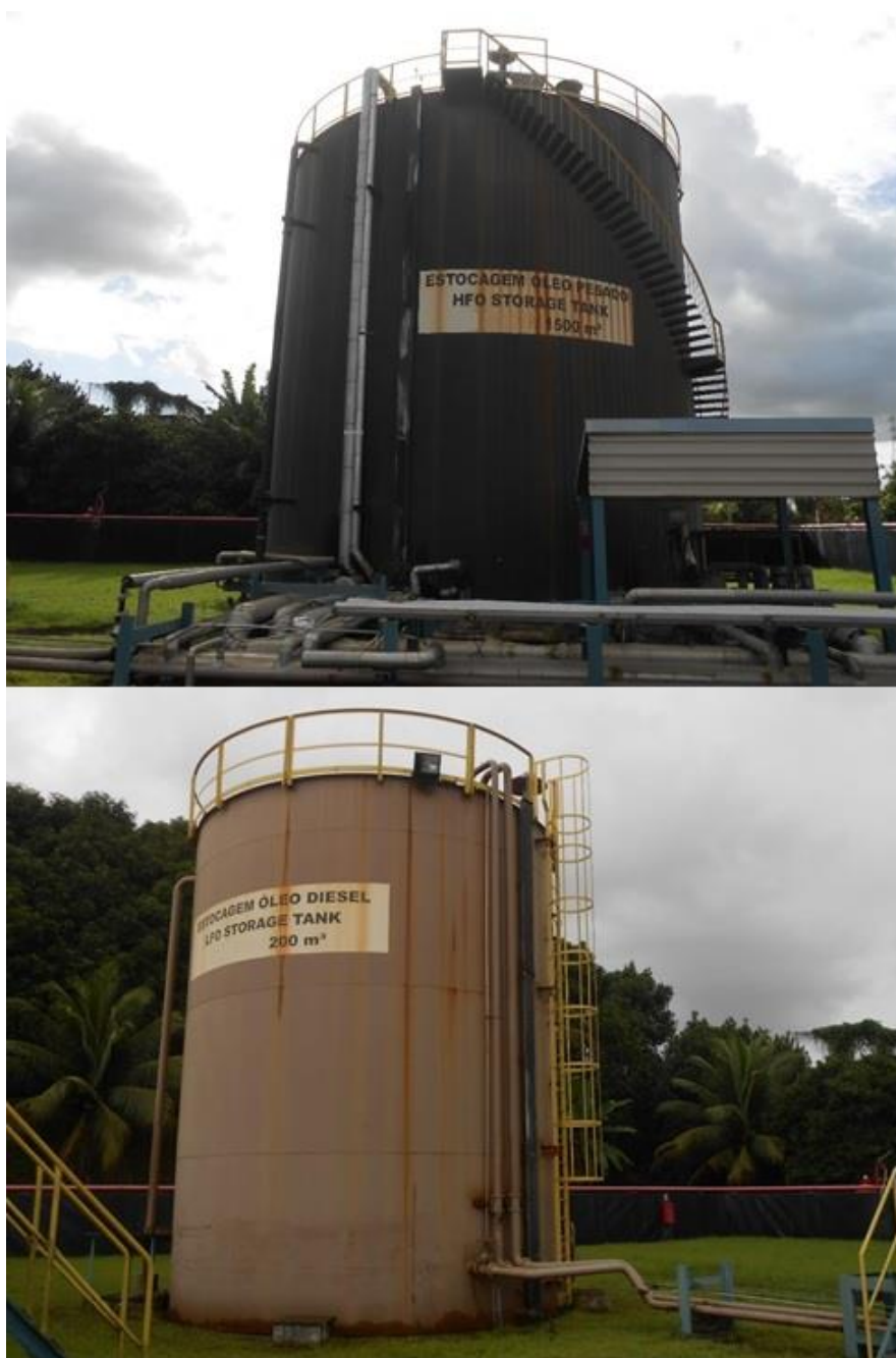
Figura 7 – Fotos dos tanques que armazenam HFO (acima) e LFO
