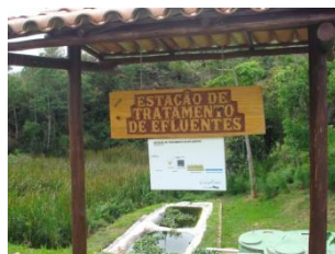
Estação de tratamento de esgoto
